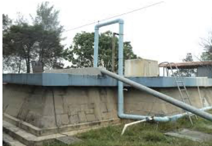
Figura 3. Tanque de almacenamiento de agua. Fuente: tomada de aguasdesiguatetepeque.com
