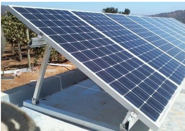
Figura 5. Conjunto de paneles fotovoltaicos. Fuente: Comisión Federal de Electricidad (2019).
